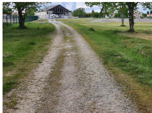
Route couverte d'un peu de végétation – Mai 2022
